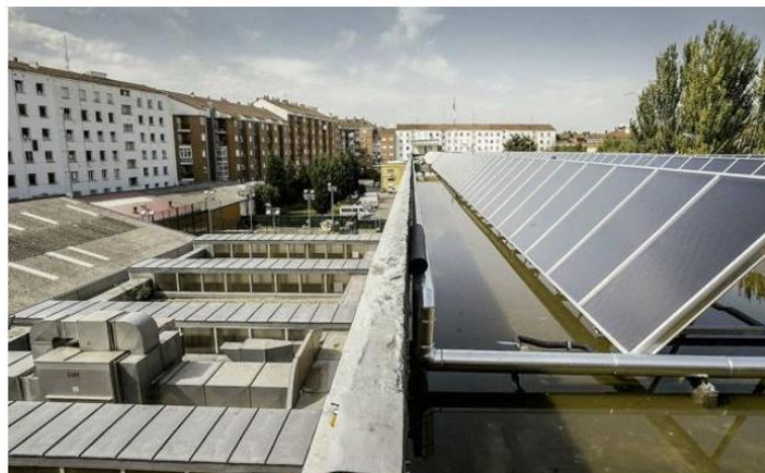
Placas solares instaladas en un edificio de Vitoria. / JESÚS ANDRADE
